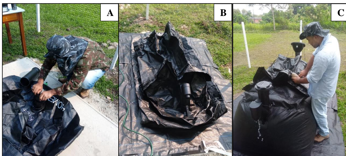
Figura 2 - A) Encaixe do tubo de admissão de resíduos; B) Enchimento de 1.200 litros de água; C) Preenchimento com sacos de areia, município de Tabatinga – Am, 2022
